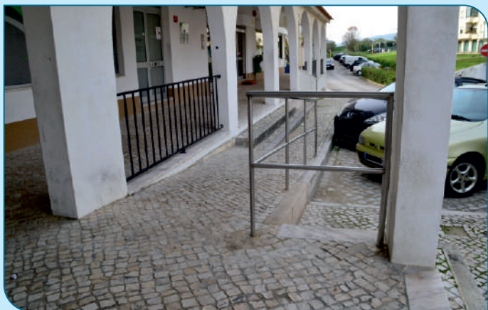
Colocação de um corrimão, varandim e criação de uma rampa junto do Largo da Fonte no Sobralinho.
